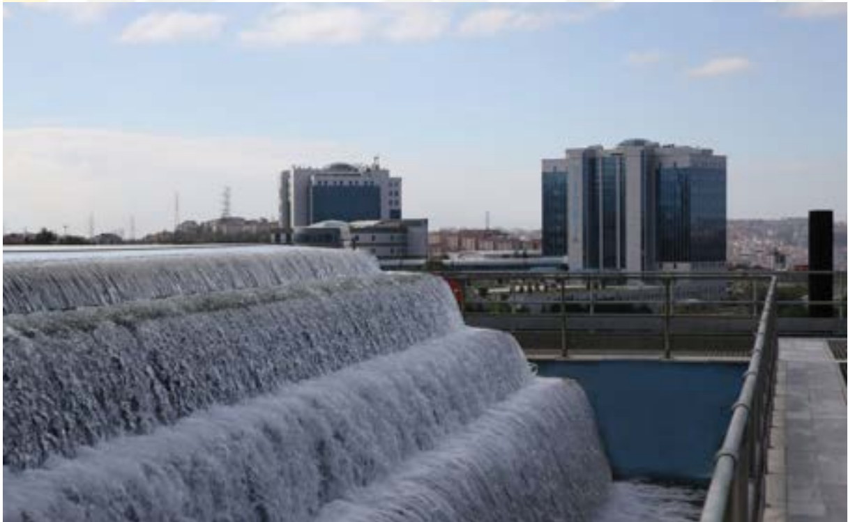
Su Arıtma Tesisi
