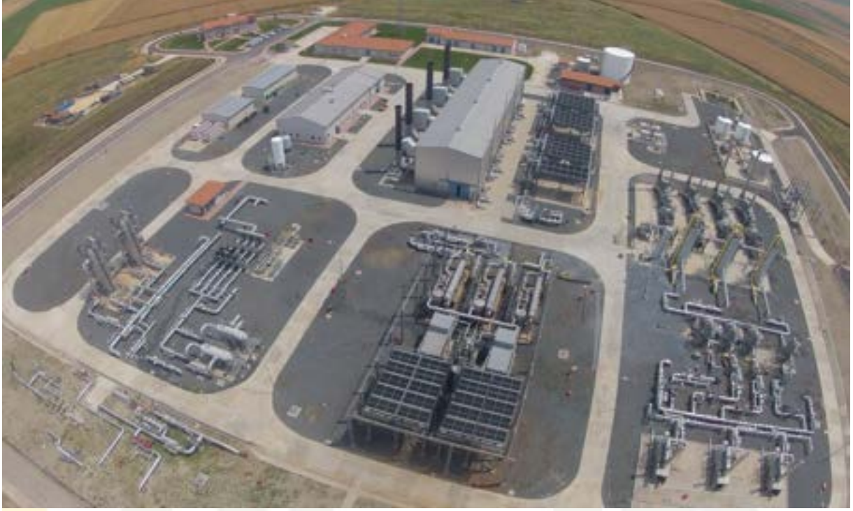
Silivri Doğalgaz Depolama Tesisi
